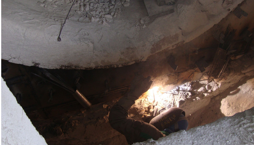
Figura 8: Reparo no cabeçote do forno rotativo da empresa Tecnocal Ltda Fonte: Dados da pesquisa aplicada.
