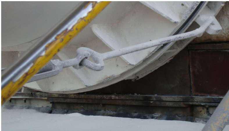
Figura 9: Reparo no cabeçote do forno rotativo da empresa Tecnocal Ltda Fonte: Dados da pesquisa aplicada.
