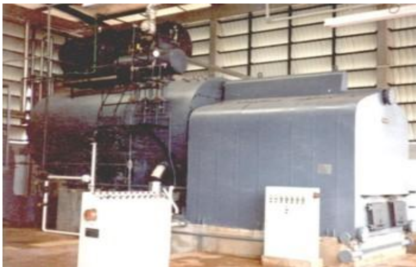
FIGURA 10 – Caldeira a Biomassa
