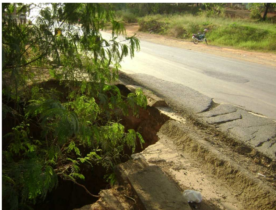
FIGURA 11 – Erosão próxima a rodovia BR354
