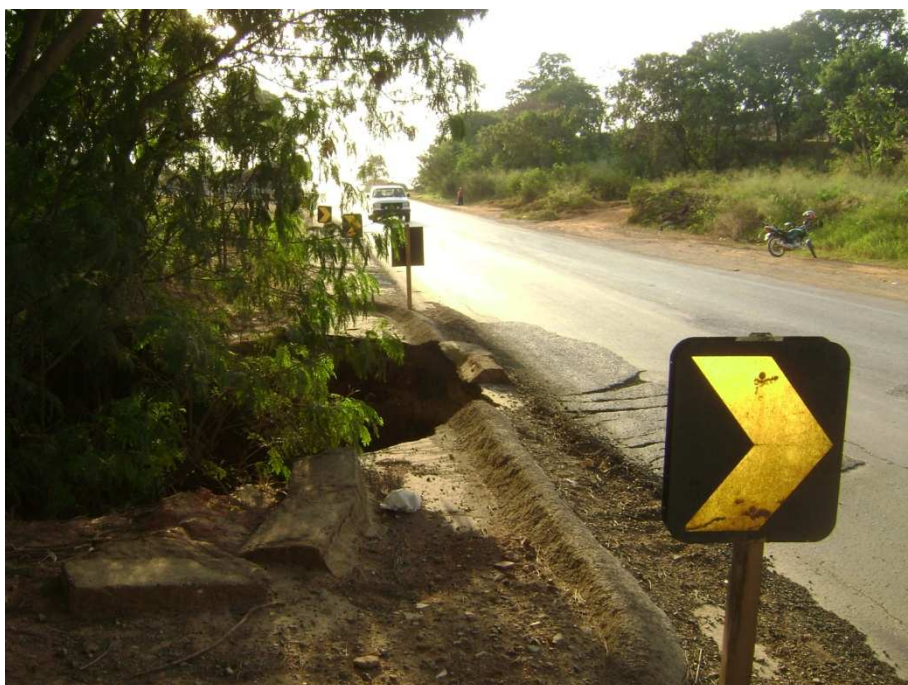
FIGURA 13 – Erosão próxima a rodovia BR354
