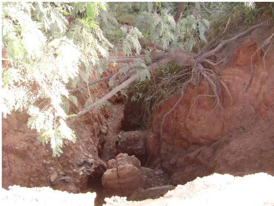
FIGURA 12 – Erosão a ser tratada próxima a rodovia BR354
