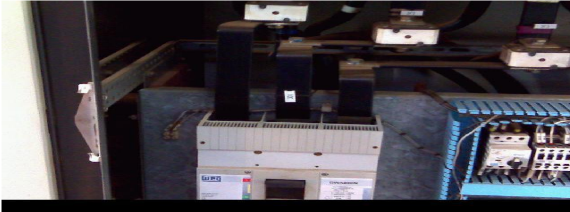
FIGURA 2 :Foto Digital Ccm Torre de Resfriamento Destilaria FONTE: Elaboração Própria
