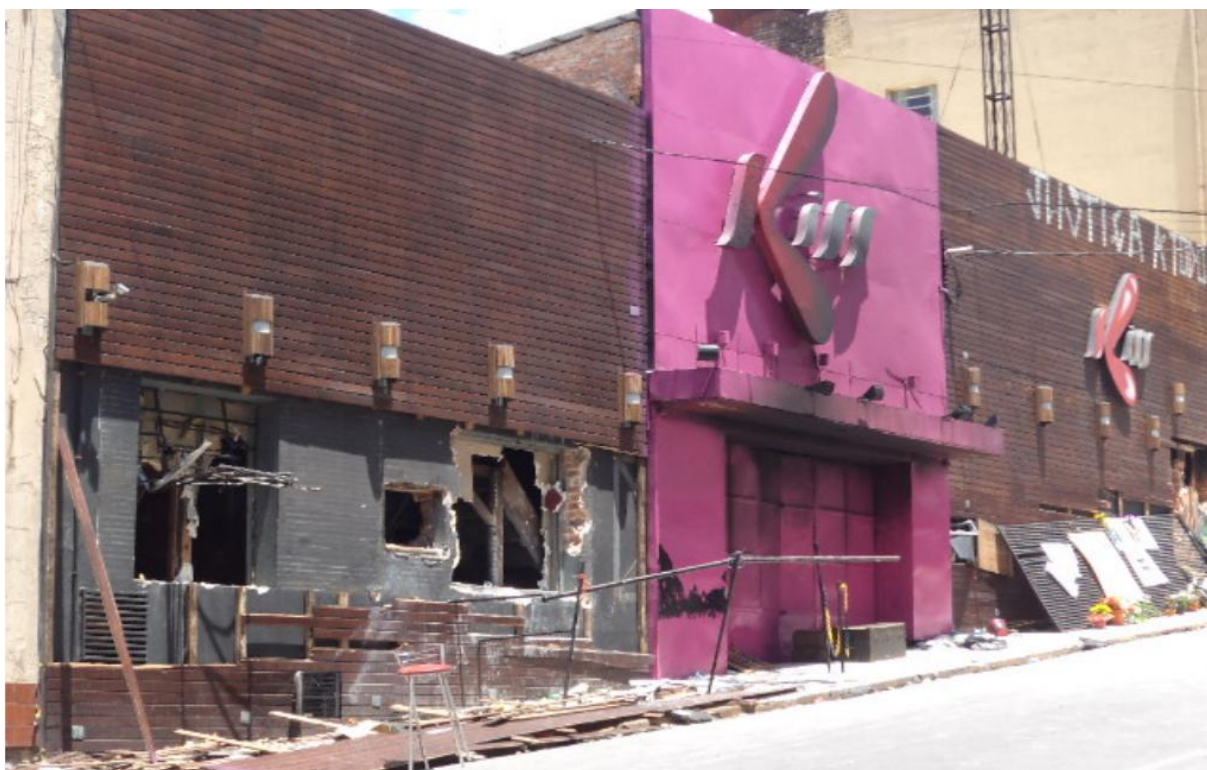
Figura 14 – Fachada da Boate Kiss após incêndio
