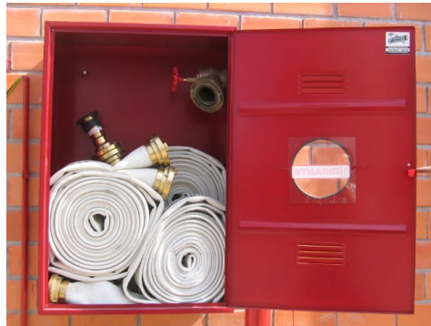
Figura 18 – Vista interna do abrigo de mangueira com hidrante.
