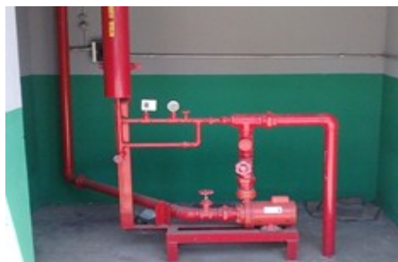
Figura 19 – Bomba de incêndio.
