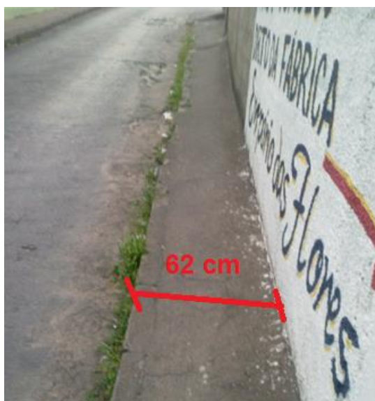
Figura 88 – Calçada com largura inferior que o permitido por norma
