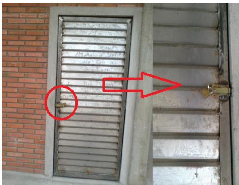
Figura 85 – Banheiro público trancado com cadeado
