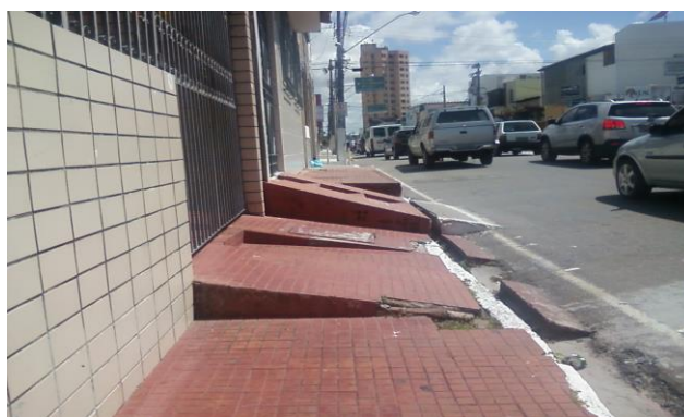
Figura 39 – Desnível em calçada
