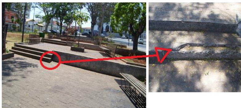
Figura 56 – Degraus em mau estado de conservação
