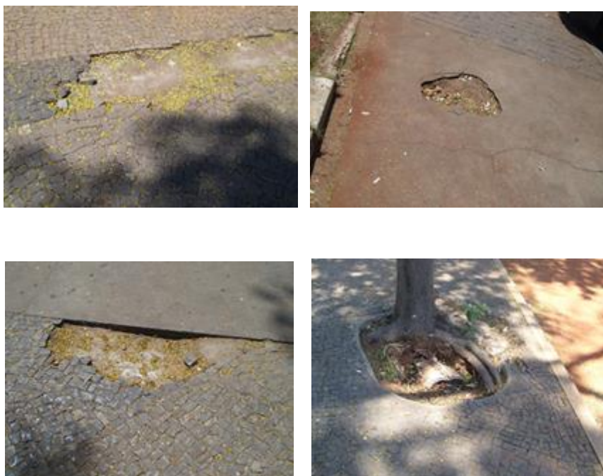
Figura 54 – Danificações em calçadas
