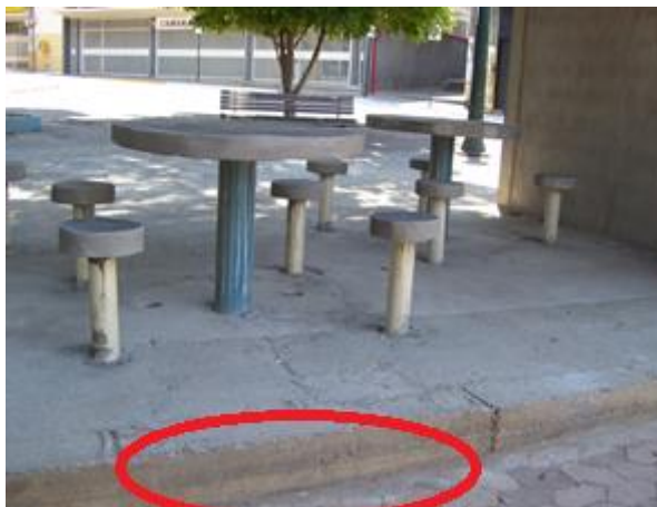
Figura 79 – Degrau dificultando o acesso
