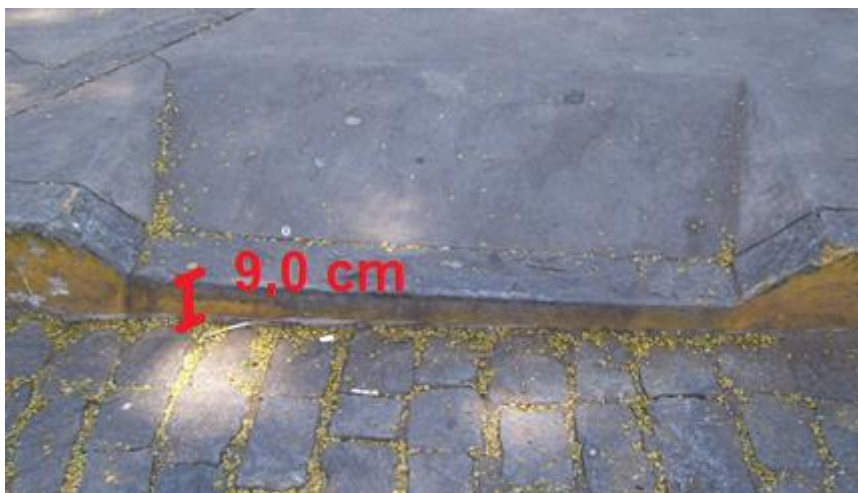
Figura 64 – Guia rebaixada com altura indevida
