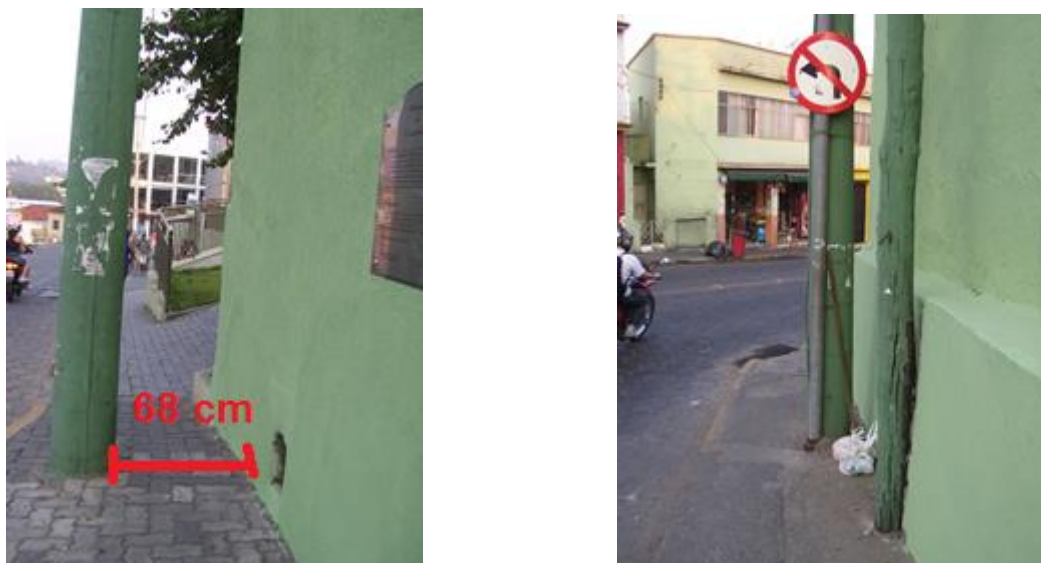
Figura 91 – Calçada mal dimensionada
