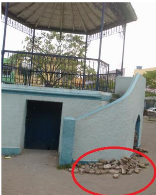
Figura 82 – Coreto da Praça Ferreira Pires, entulhos próximos à escada
