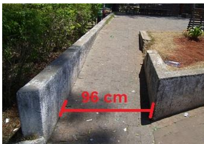
Figura 57 – Largura da área de acesso destinada para deficientes inferior a 1,20 m.
