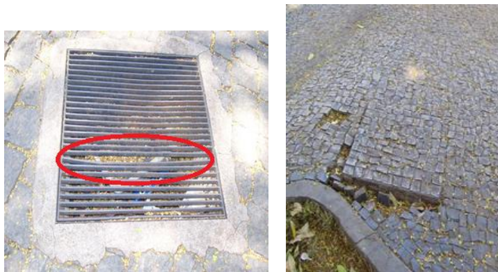
Figura 58 – Grelha com defeito e caixa de inspeção desnivelada em relação ao piso
