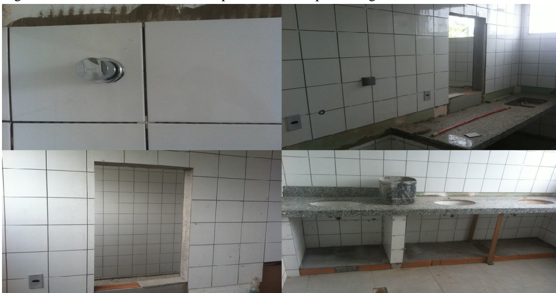
Figura 45 - Revestimento cerâmico aplicado sobre o placa de gesso verde
