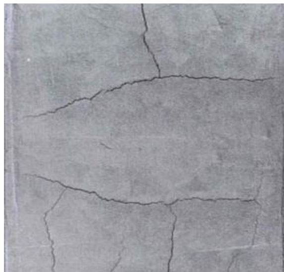
Figura 9 – Concreto com fissuras por retração
