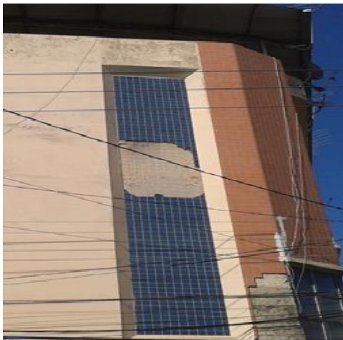
Foto 1: Prédio com descolamento de placas na cidade de Formiga
