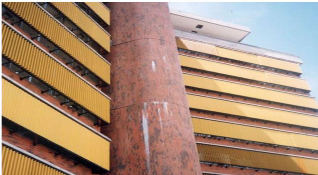
Figura 9: Eflorescência no revestimento cerâmico em prédio em São Paulo
