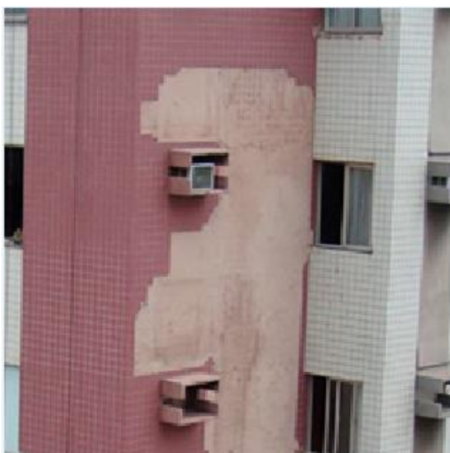
Figura 7: Destacamento de placas cerâmicas em um prédio
