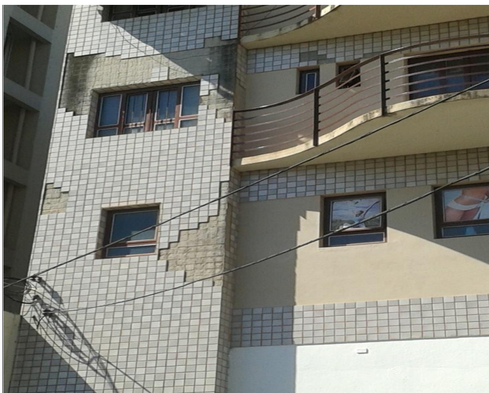
Foto 4: Fachada com destacamento de placas na cidade de Arcos
