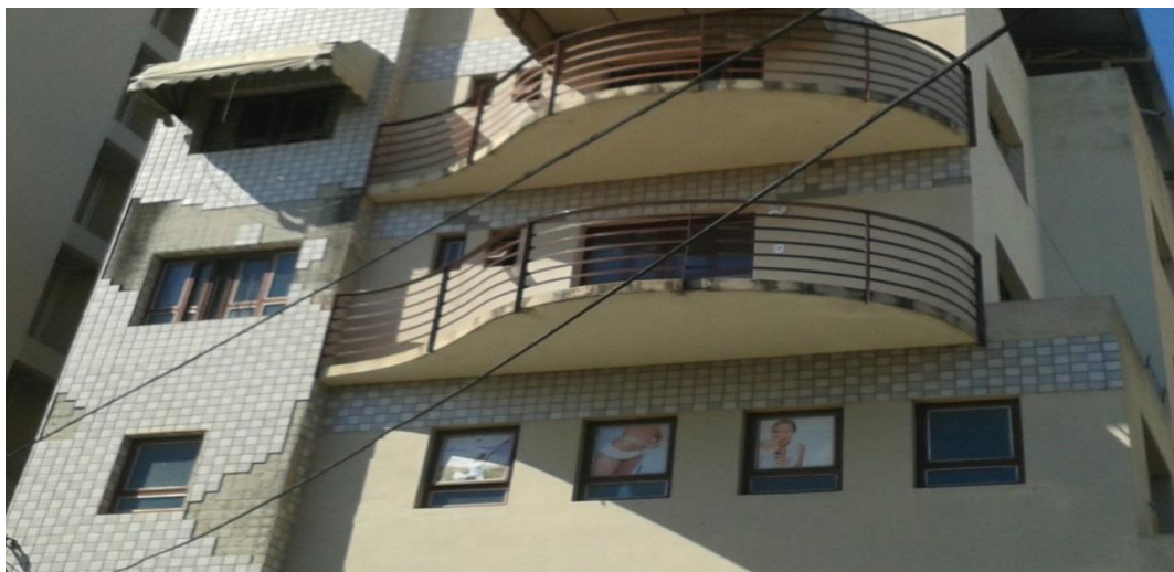
Foto 3: Prédio com destacamento de placas na cidade de Arcos
