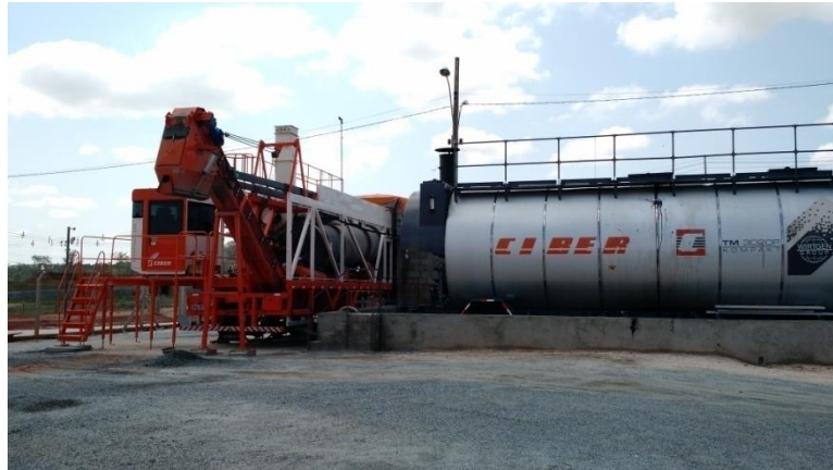
Figura 3 - Usina de asfalto volumétrica de contra fluxo
