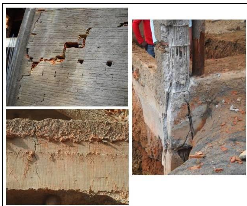
Figura 15 - Patologias na estrutura
