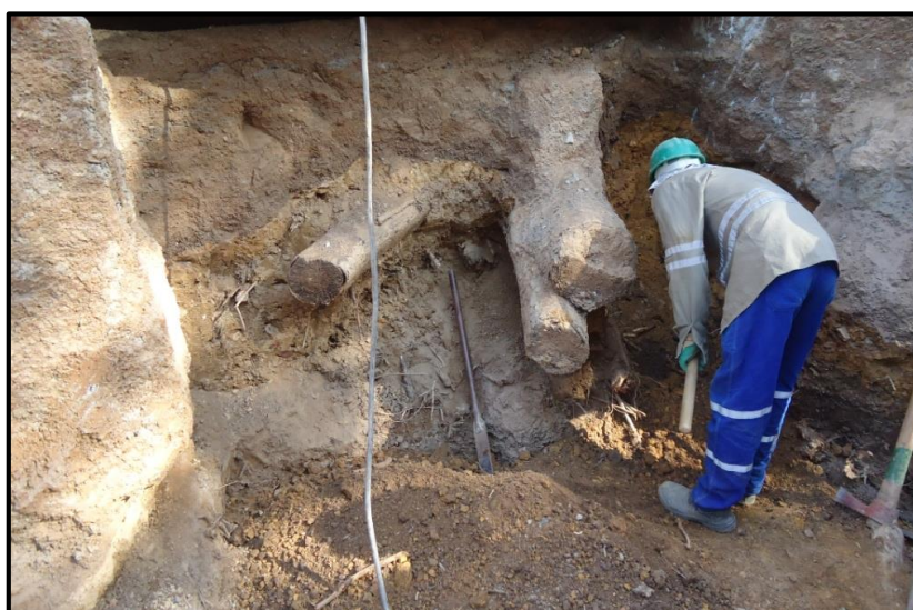
Figura 13 - Troncos de árvore no corpo do aterro
