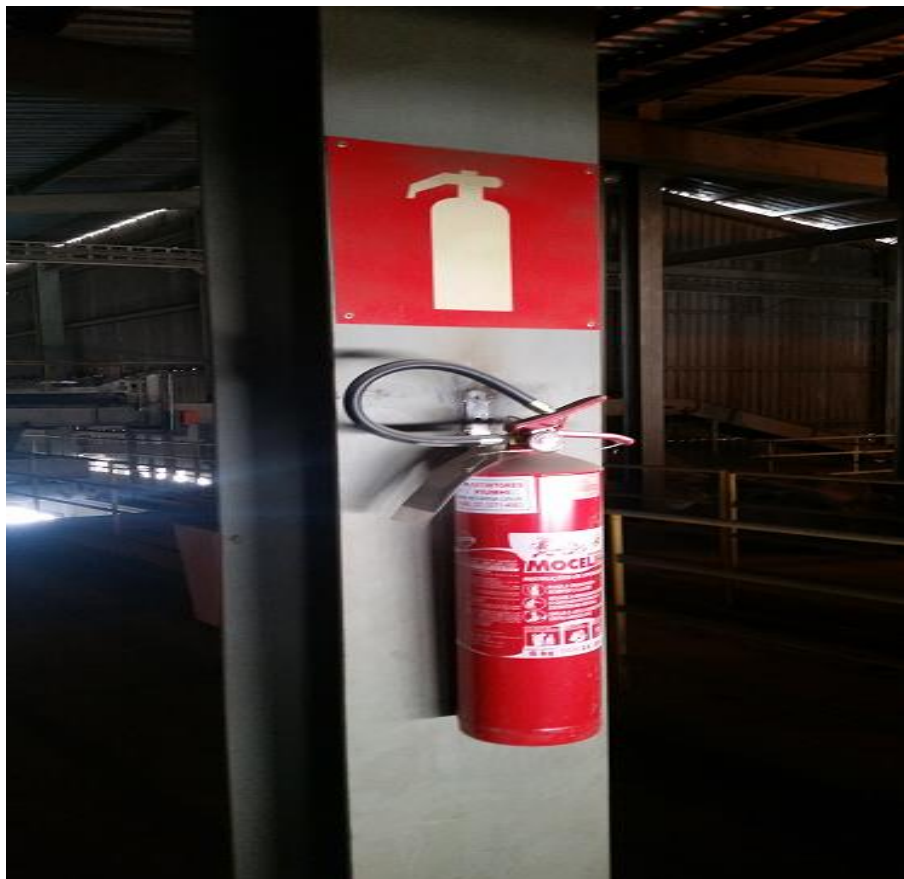
Figura 6 – Extintor de incêndios.
