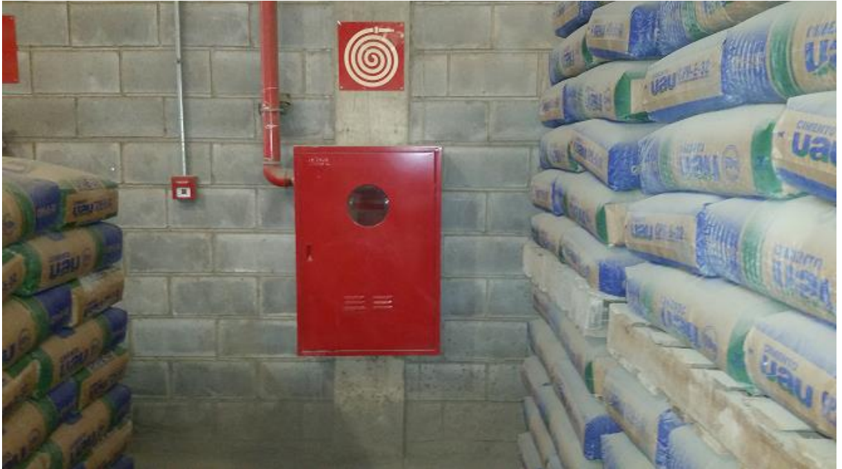
Figura 5 – Hidrante de proteção contra incêndios.
