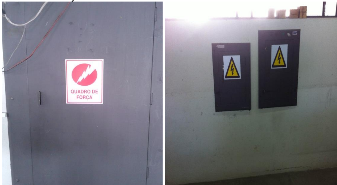
Figura 12 – Sinalização dos sistemas elétricos
