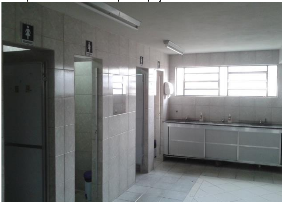
Figura 16 – Aspecto dos sanitários após inspeção
