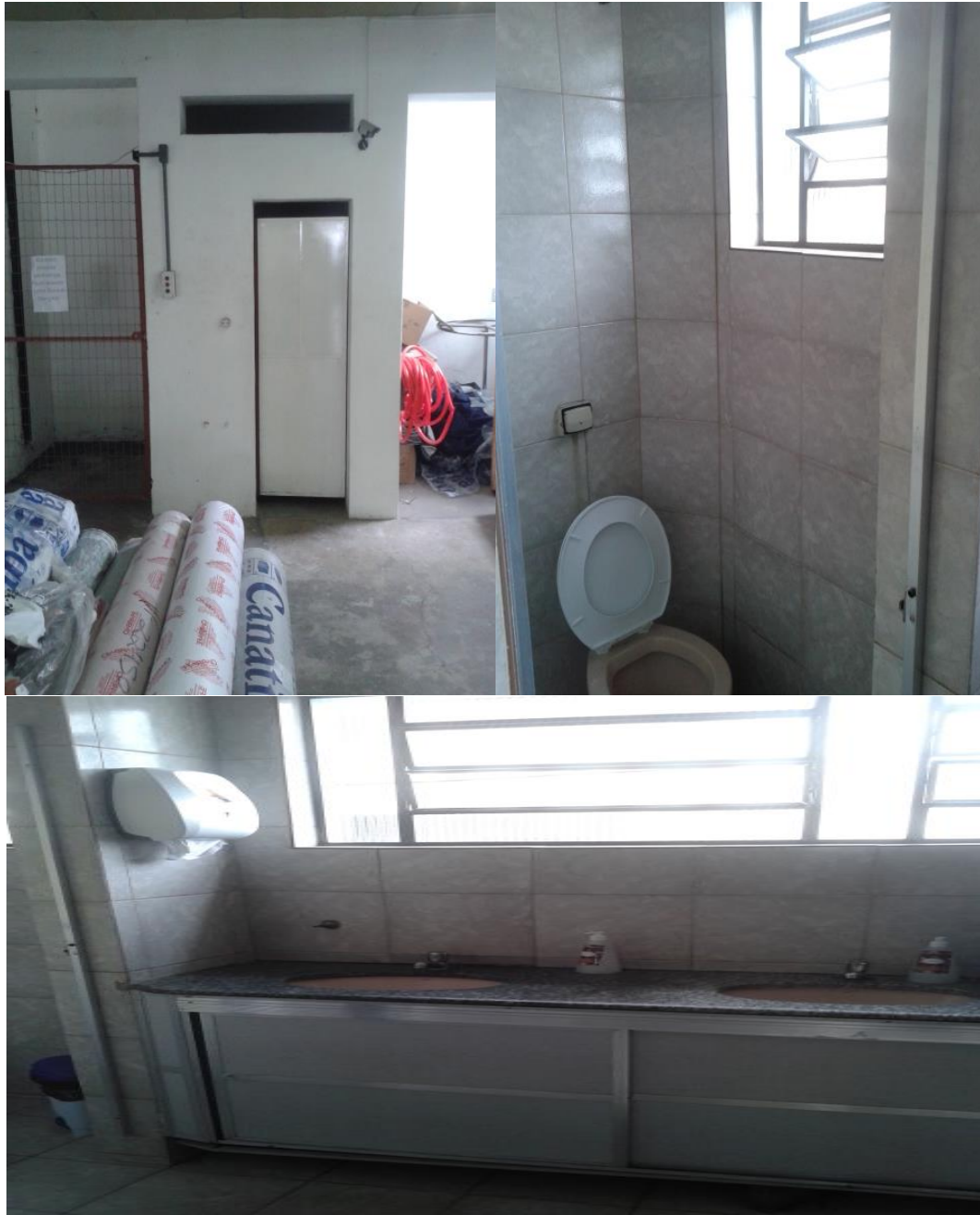
Figura 14 – Ventilação dos sanitários
