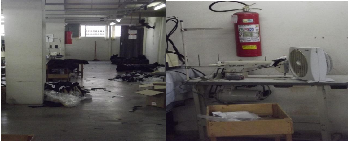
Figura 9 – Proteção contra incêndios antes da vistoria
