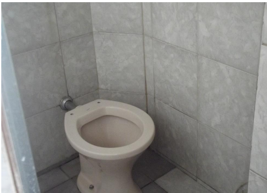
Figura 6 – Condições dos sanitários antes da vistoria
