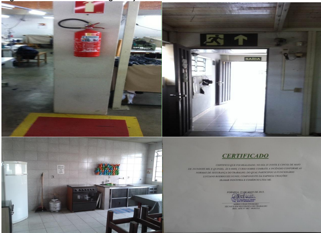
Figura 23 – Material de segurança contra incêndios
