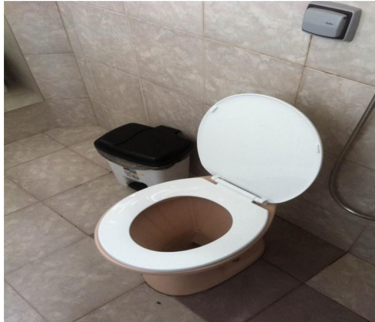
Figura 15 – Condições dos vasos sanitários após vistoria.
