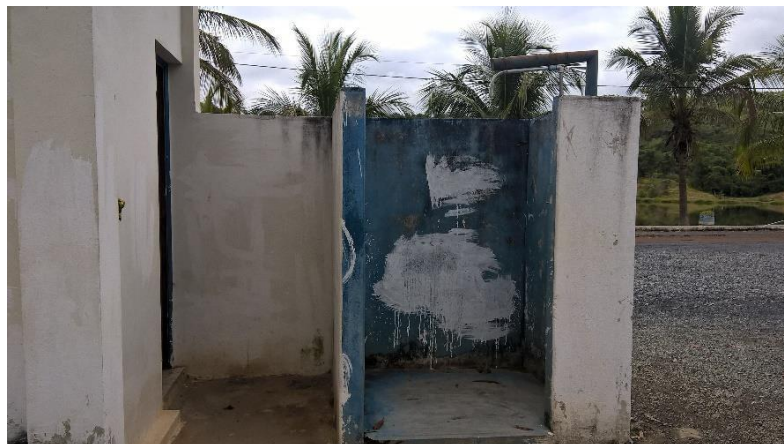
Figura 96 – Paredes dos Banheiros e vestiários rabiscadas com tintas, e duchas improvisadas
