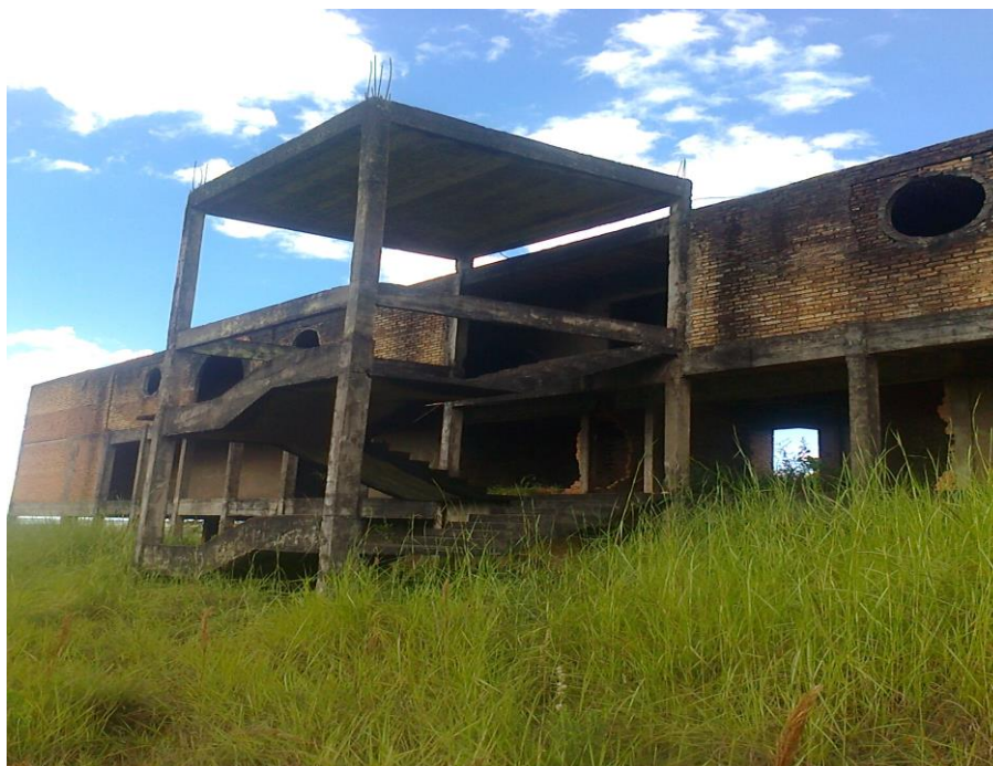
Figura 68 – Antiga edificação em ruínas
