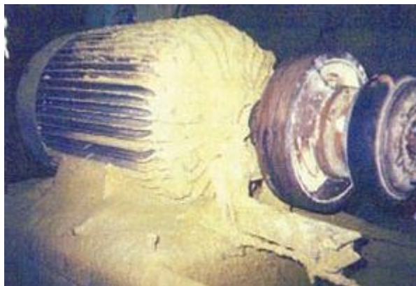
Figura 27 – Motor elétrico coberto com poeira agrícola
