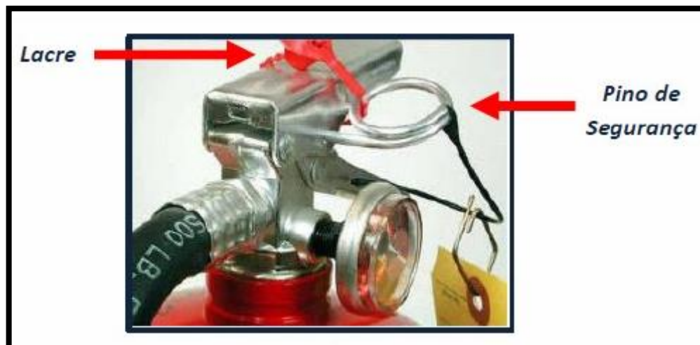
Figura 35 – Sistema de segurança de um extintor com lacre e pino de segurança.
