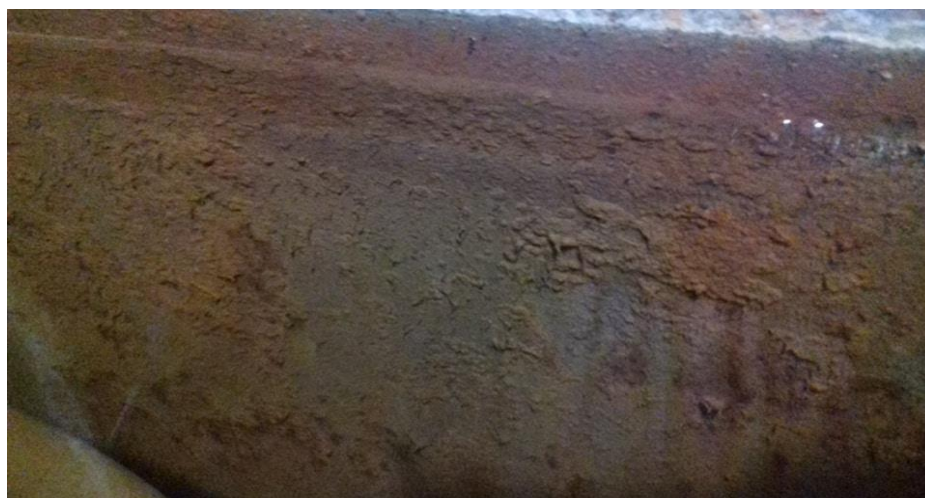
Figura 8 - Incrustações encontradas dentro de um reservatório de resfriamento de água
