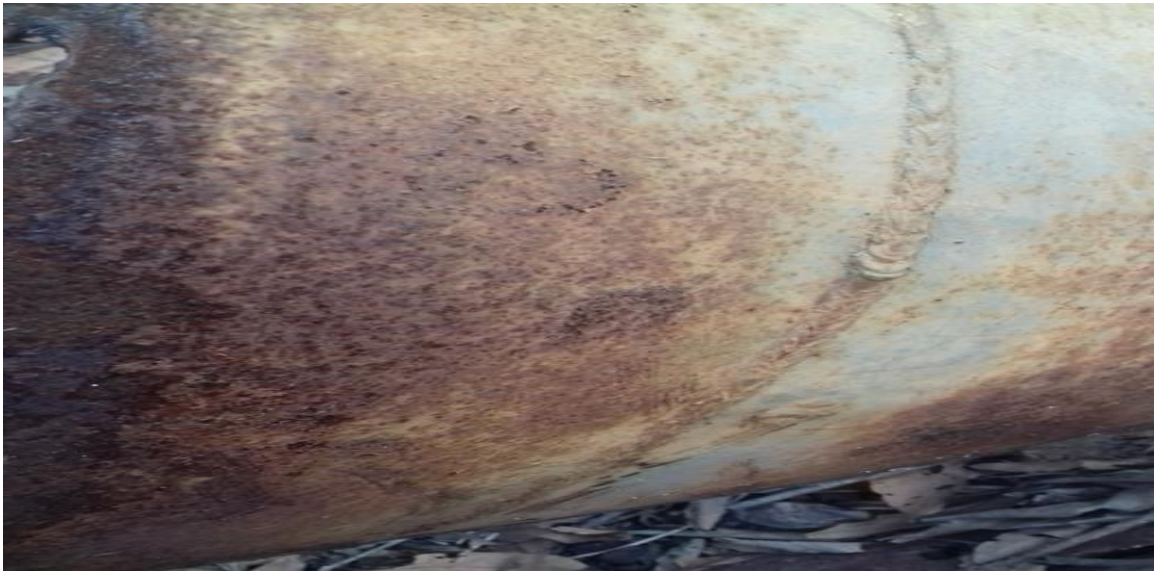
Figura 9 - Corrosão macroscópica encontrada em um tubulação
