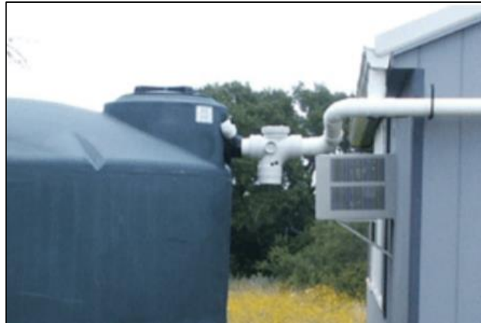
Figura 9 – Detalhe da válvula para descarte inicial de água pluvial.
