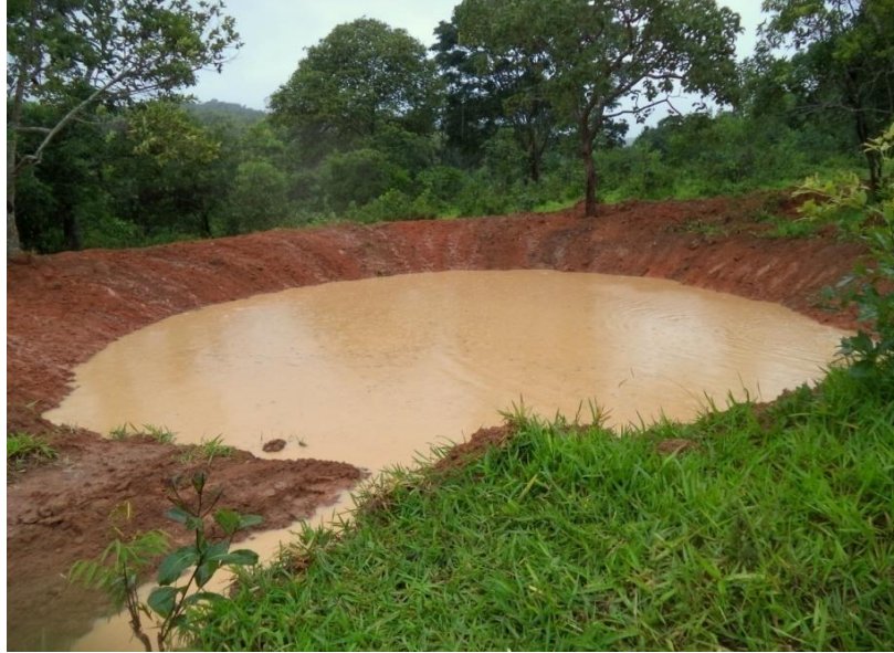
Figura 11 – Bacia de contenção após precipitação pluviométrica.
