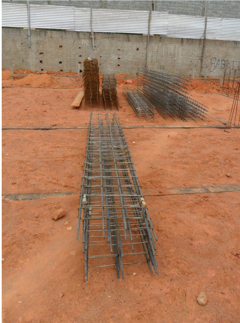
Figura 5 – Ferragens expostas no terreno
