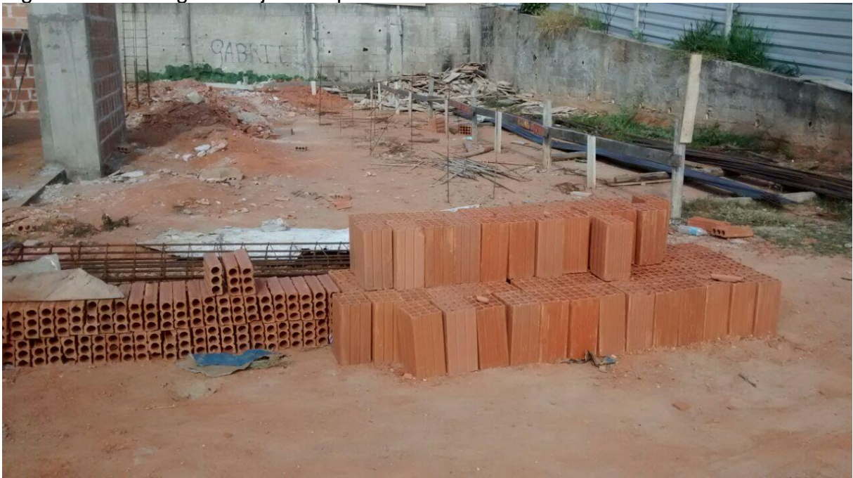
Figura 21 – Ferragens e tijolos expostos no terreno
