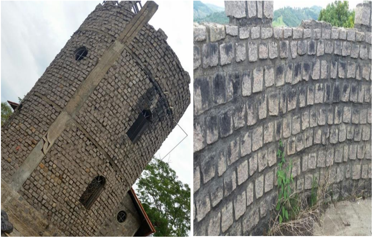
Figura 05 – Paredes com sujidades acumuladas
