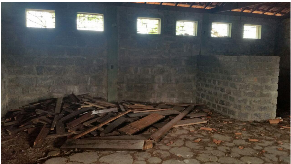
Figura 06 – Condição dos pisos
