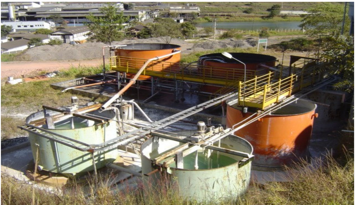
FIGURA 9 – Estação de Tratamento de Efluente Químico (ETEQ)
