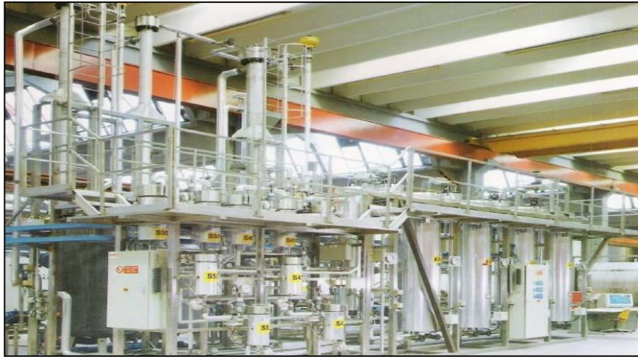
Figura 9 - Planta industrial de extração de dióxido de carbono supercrítico
