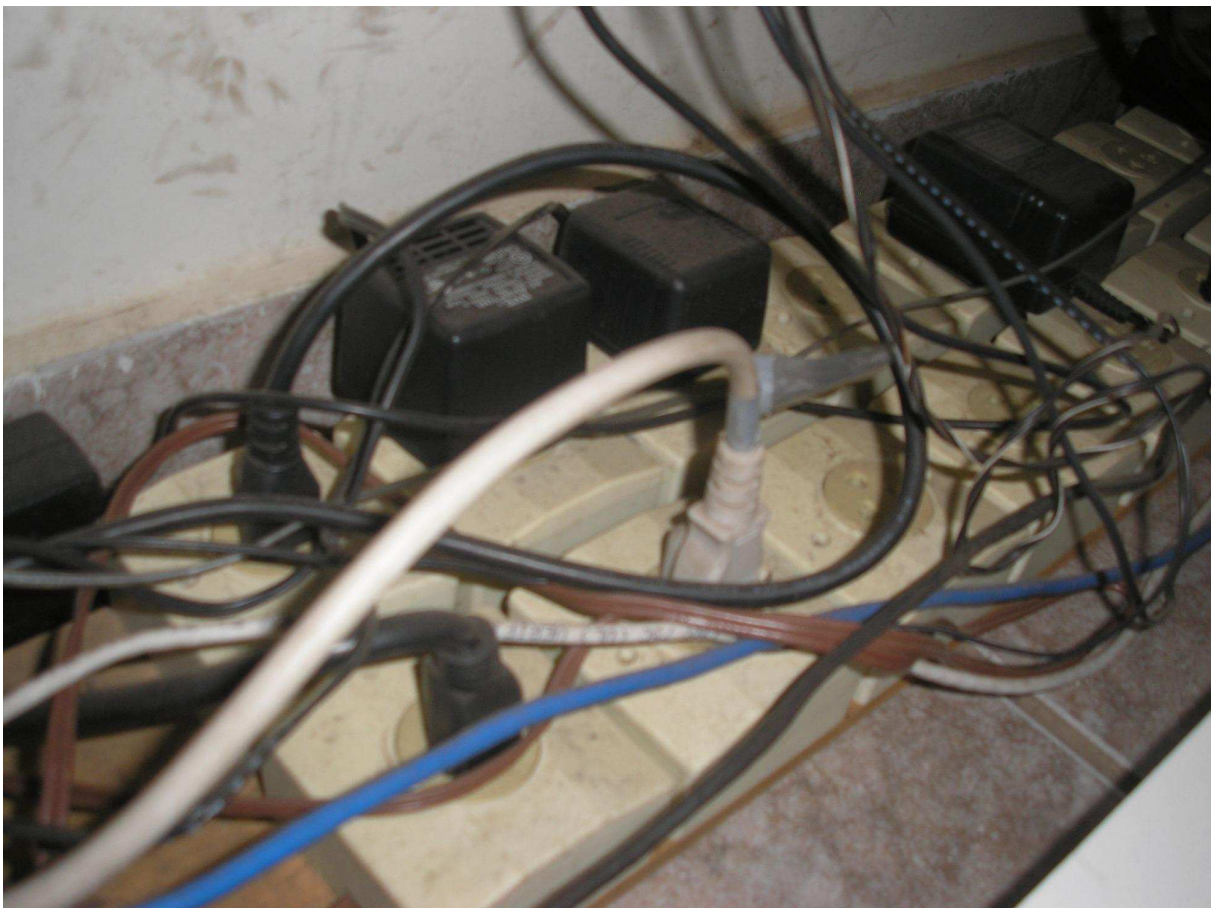
FIGURA 7 – Instalações elétricas velhas e sujas.
