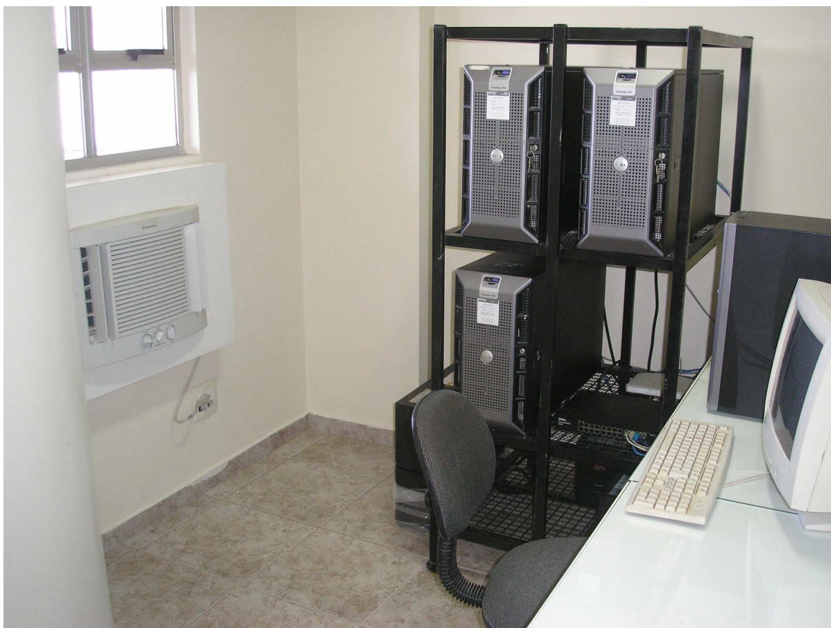
FIGURA 15 – Interior da sala nova de servidores.
