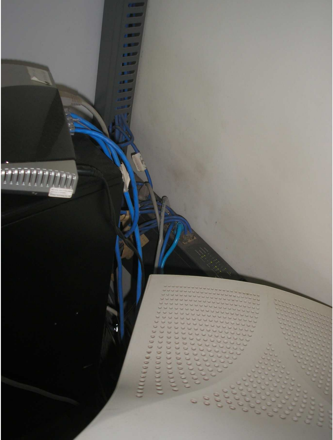
FIGURA 8 – Cabos sem identificação.
