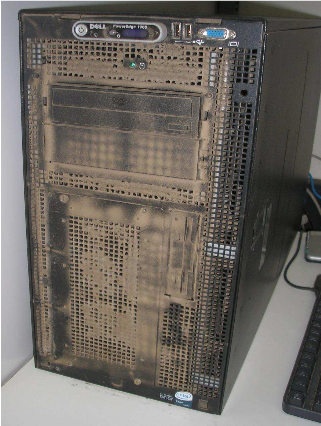
FIGURA 9 – Sujeira acumulada no interior dos servidores.
