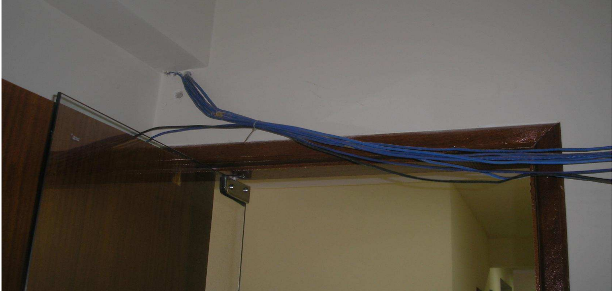
FIGURA 18 – Cabeamento passando por fora da parede.
