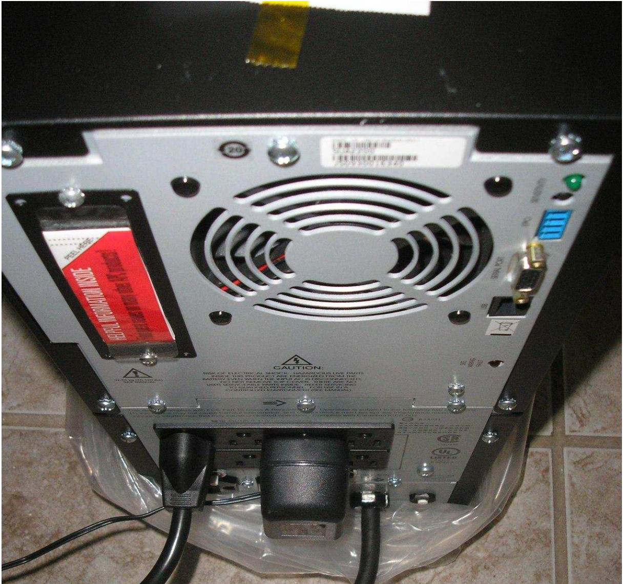
FIGURA 24 – Instalações elétricas novas e protegidas por no-breaks.
