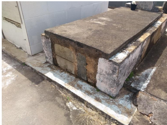
Figura 23 – Fechamento Mal Feito dos Túmulos
