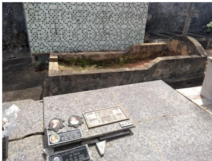
Figura 19 – Falta de Manutenção dos Túmulos
