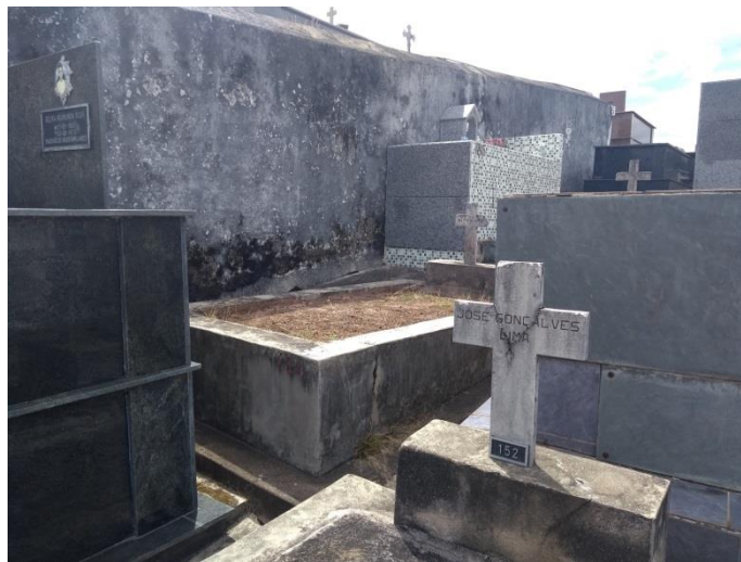
Figura 20 – Patologias na Alvenaria
