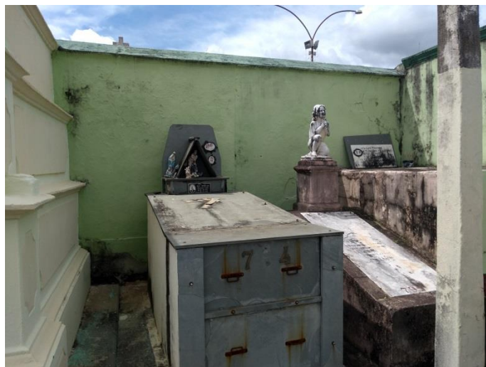
Figura 21 – Patologias na Alvenaria
