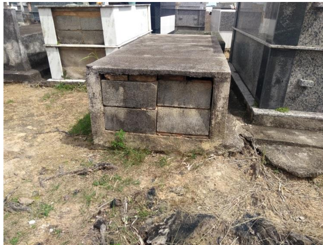
Figura 22 – Fechamento Mal Feito dos Túmulos
