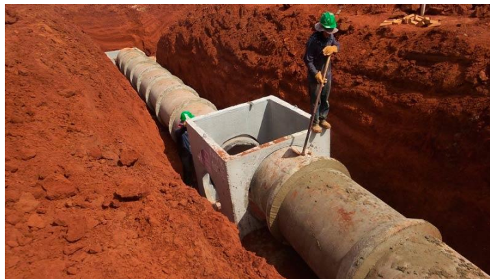
Figura 7 - Caixa de ligação pré moldada
