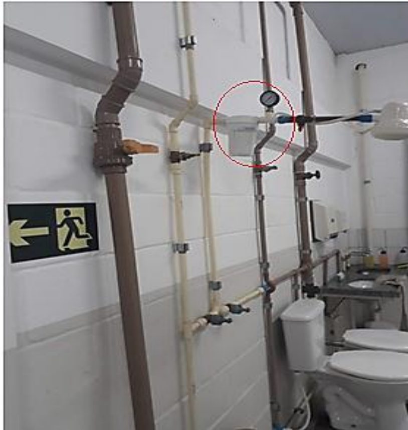
Figura 2 - Sistema hidráulico com a inserção do declorador e manômetro
