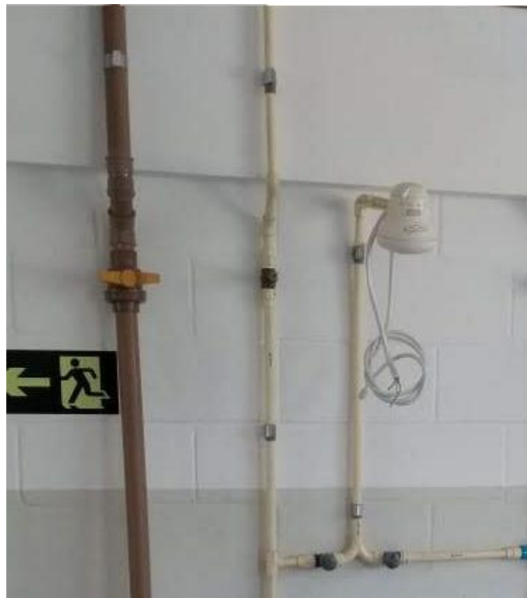
Figura 1 - Sistema hidráulico existente no laboratório
