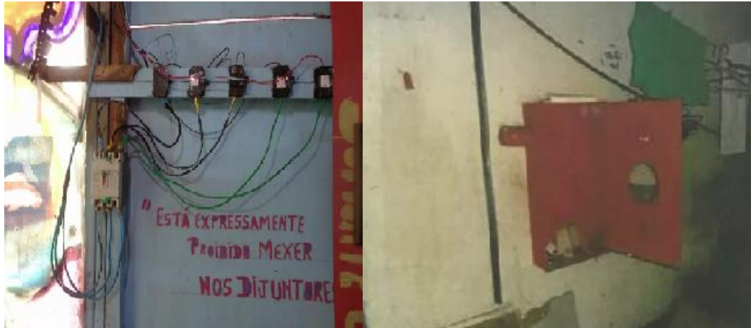
FIGURA 20-Instalações precárias do edifício.
