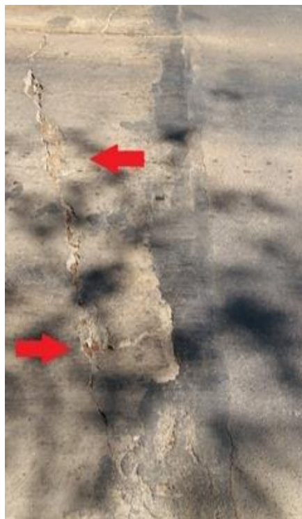
Figura 37 - Fissura no pavimento.
