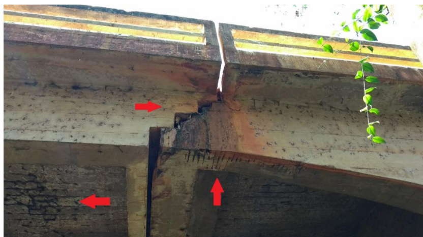
Figura 36 - Corrosão das armaduras
