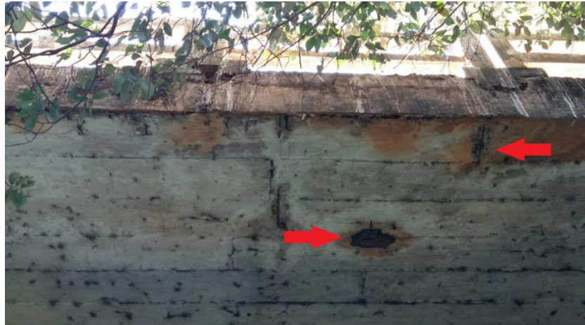
Figura 31 - Lixiviação e armadura expostas
