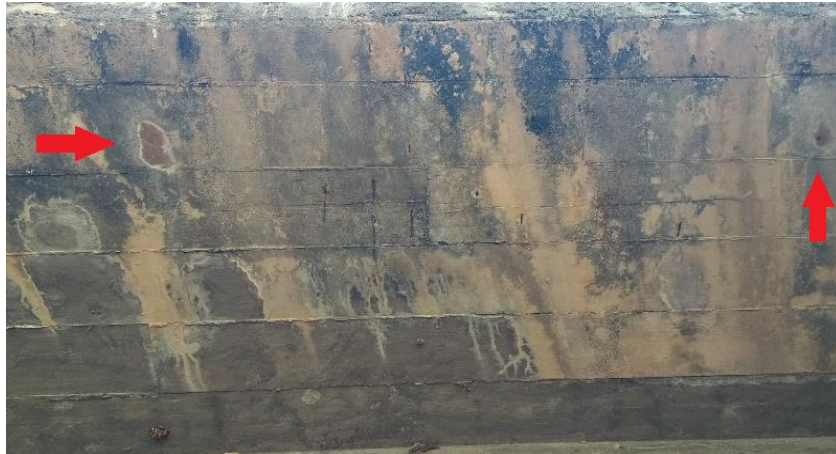
Figura 29 - Lixiviação parte inferior do tabuleiro
