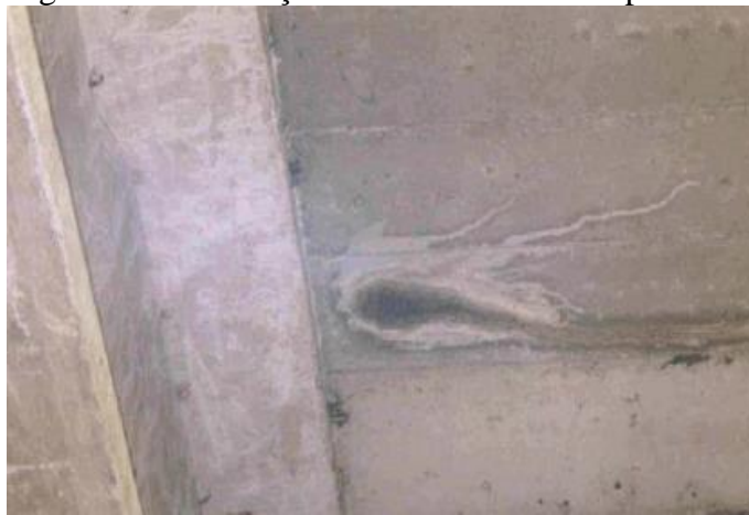
Figura 16 - Lixiviação no tabuleiro de uma ponte
