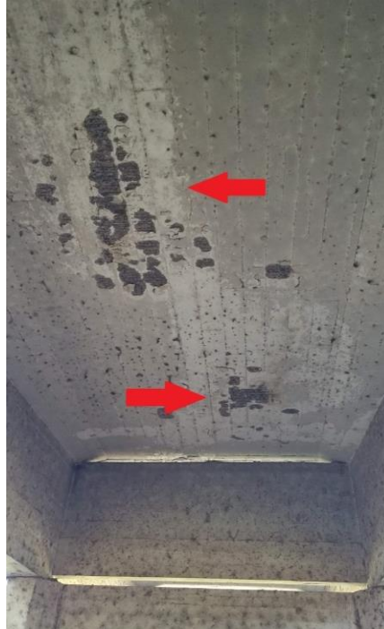
Figura 38 - Armadura exposta no tabuleiro
