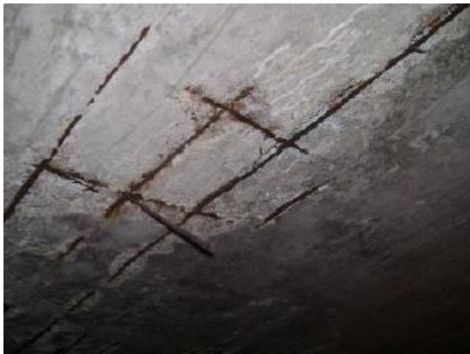
Figura 15 - Corrosão nas armaduras
