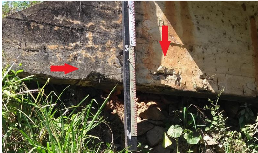
Figura 33 - Segregação e armadura exposta
