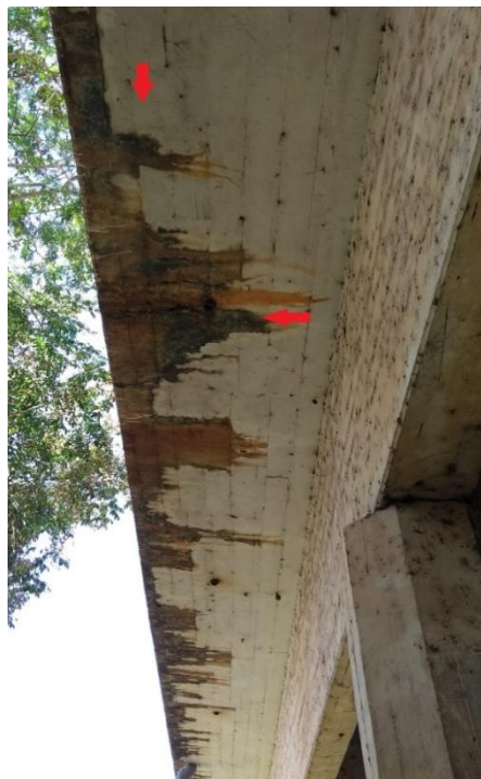
Figura 39 - Infiltração parte inferior do tabuleiro
