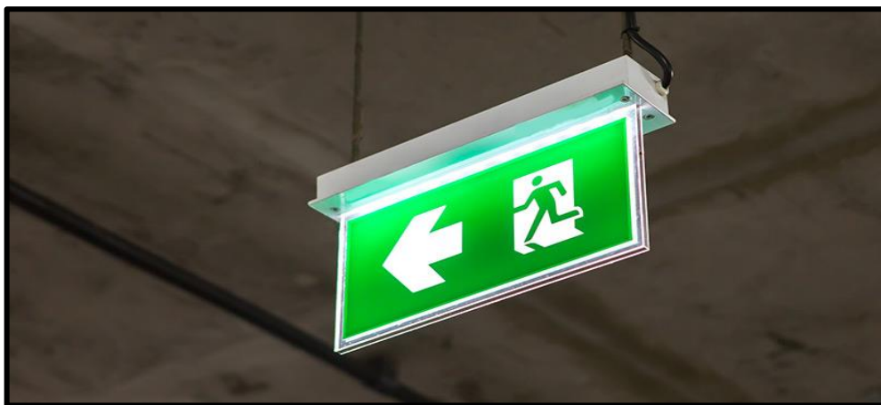
Figura 10 - Iluminação de emergência.
