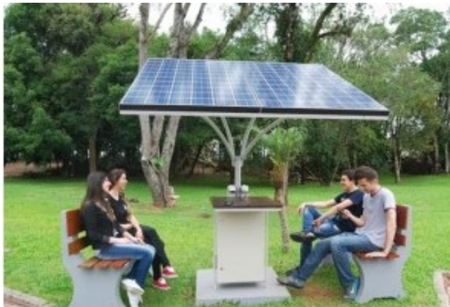
Figura 18 – Painel fotovoltaico instalado em pontos de ônibus da Universidade de Santa Catarina.
