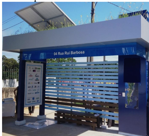
Figura 19 – Ponto de ônibus com energia fotovoltaica instalado em Florianópolis.
