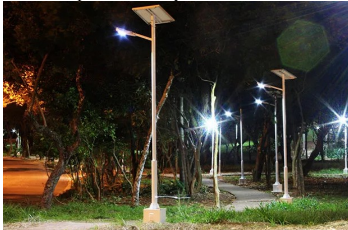
Figura 17 - Postes de iluminação abastecidos por energia solar na praça no Jardim Chapadão em Campinas.
