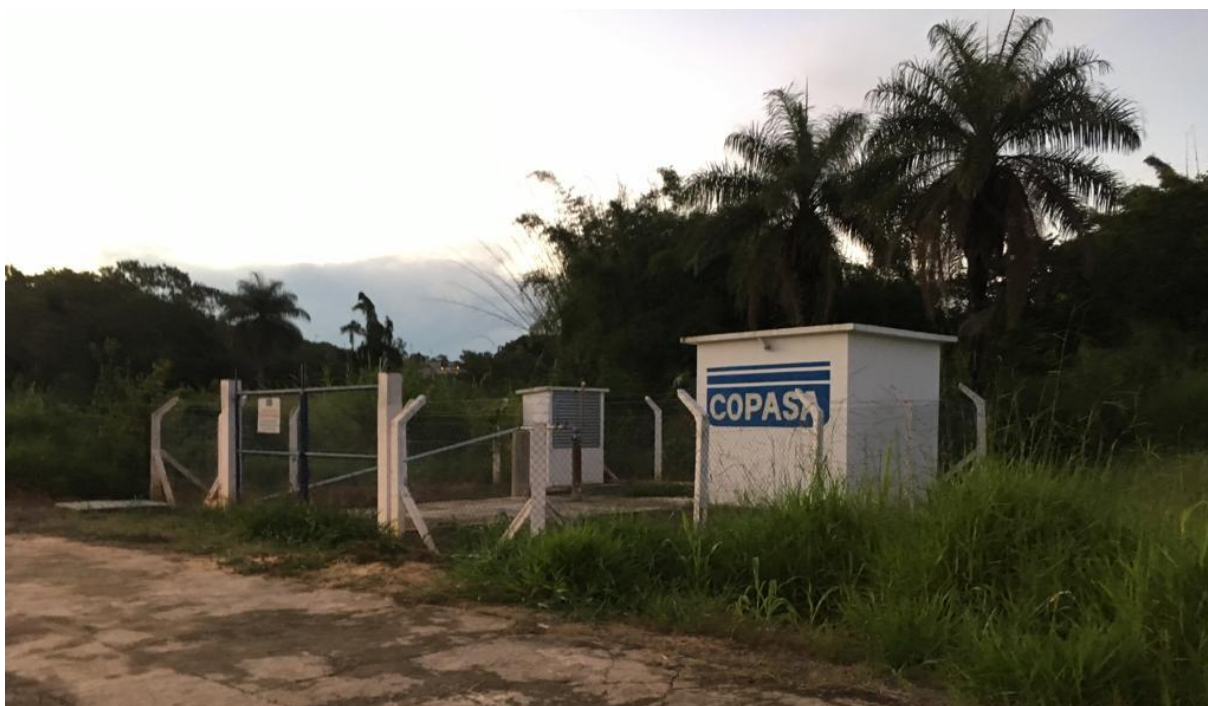
Figura 34 - Poços da COPASA
