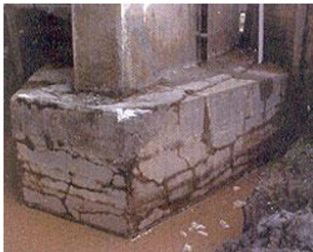
Figura 37: Fissuras devido à ocorrência da Reação Álcali-Sílica.
