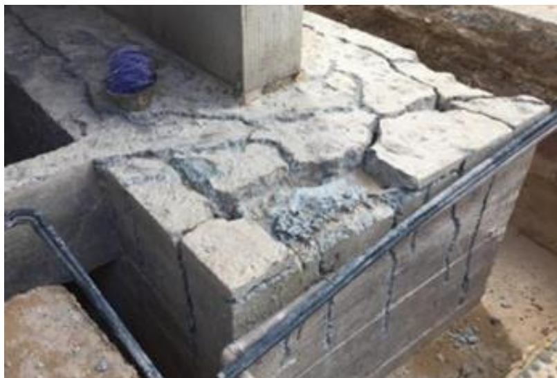
Figura 17: Fissuração do bloco provocado por RAS.
